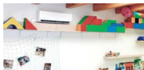
Vnútorná jednotka – ukážka inštalácie v detskom centre
